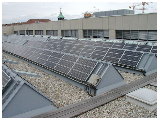
11) Photovoltaikanlage HTL Wien X
